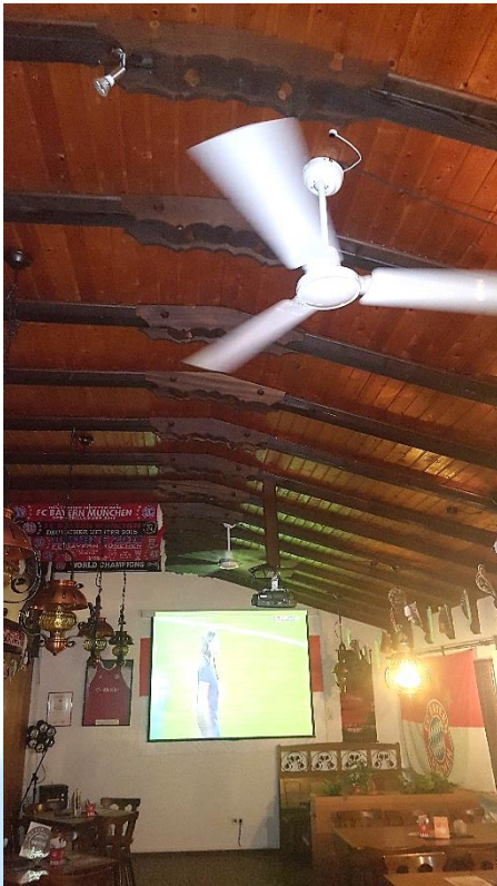
„Klimatisierung“ erhält Einzug in die Clubräume. Frischluft im Sommer, Warmluft im Winter.
